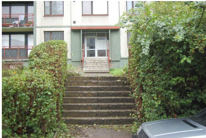
NEVYHOVUJÍCÍ STAV SCHODIŠTĚ
