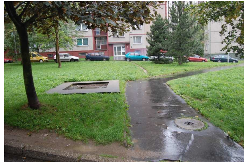
ŠPATNÝ STAV PĚŠÍCH KOMUNIKACÍ
