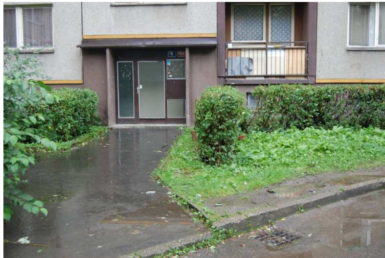
NEDOSTATEČNÉ ODVODNĚNÍ PLOCH
